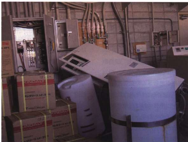
図1 倒れた機械室のタンク等
