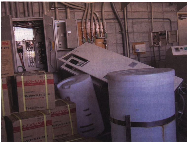
図1 倒れた機械室のタンク等
